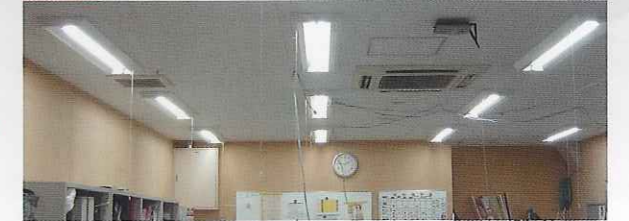
全体に光のムラがなく空間全体にほどよく光がまわっています。そのため実質的に上がった照度以上の効果が確認できます。
